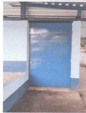
Foto 4: Se observa que se ha sustituido la puerta de madera por la de metal
