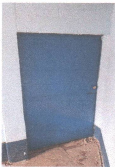
Foto 3: Se observa que se ha sustituido la puerta de madera por la de metal
